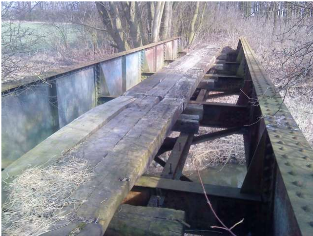
Zbytky ocelového mostu mezi Záhornicemi a Dymokury
